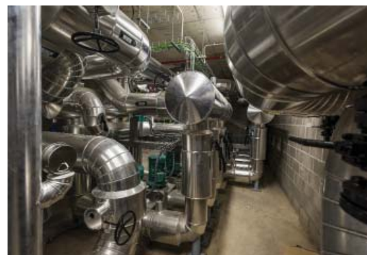
Detall de les instal·lacions
